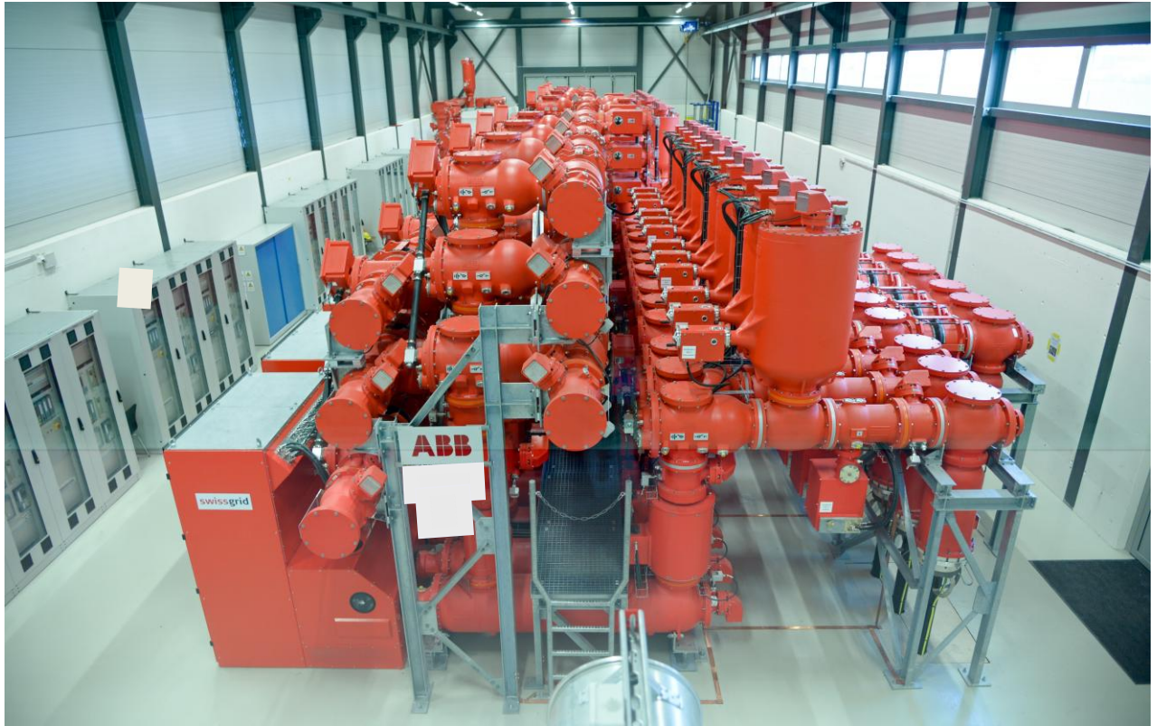
Abbildung 4: GIS-Schaltanlage (Gasisolierte Schaltanlage) Laufenburg (Foto von Swissgrid).
